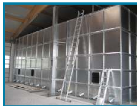
Rechtecksilo mit Fließboden
